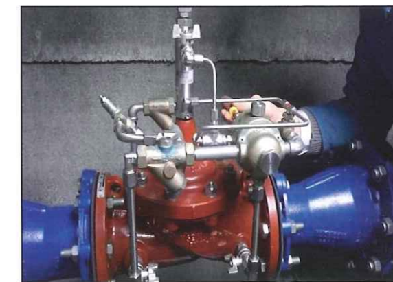
Source : Syndicat intercommunal d'alimentation en eau potable (SIAEP) du Blayais. Figure 3. Un des modulateurs installés dans le cadre du projet MAC Eau
